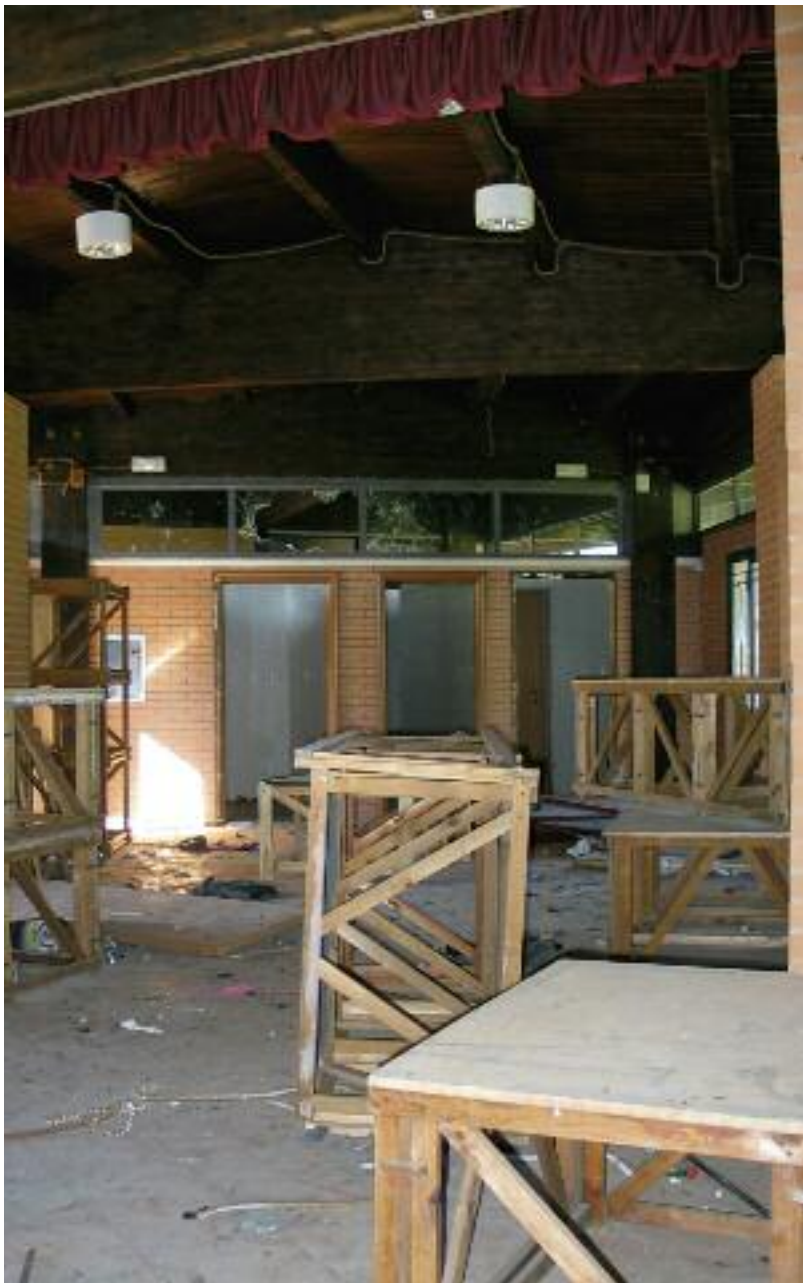
L'interno della sala semidistrutto ed invaso da rifiuti.
