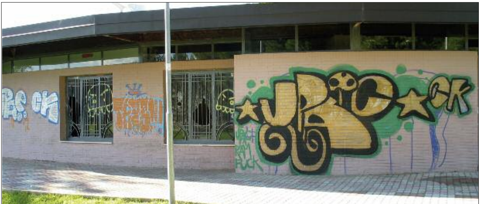
La pareti del fabbricato sono state imbrattate ed è la cosa migliore che si può vedere! Gli infissi ed i vetri (antisfondamento) distrutti. Un impegno costante al danno pubblico.
