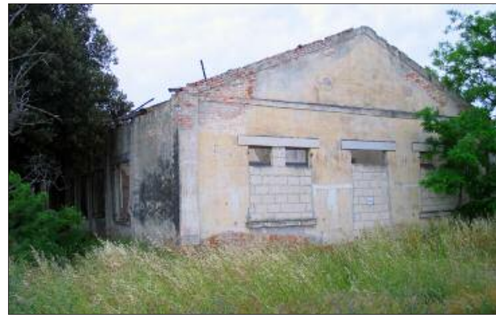
Cadente e diroccato il complesso degli alloggi ufficiali e sottoufficiali.
