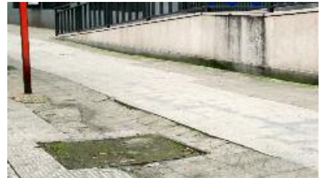
Viale Colombo ingresso INAM: anche la pavimentazione sconnessa
